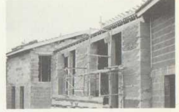
Projekt H Architekt: A. Ravereau, M. Charmont 4 WE in Reihenhäusern (2x4Z., 2x5Z.) Wände in pisé und Erdbeton, Holzbalkendecken
